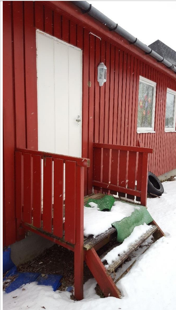
Bilde 6: Trykkimpregnert trevirke på trappene
